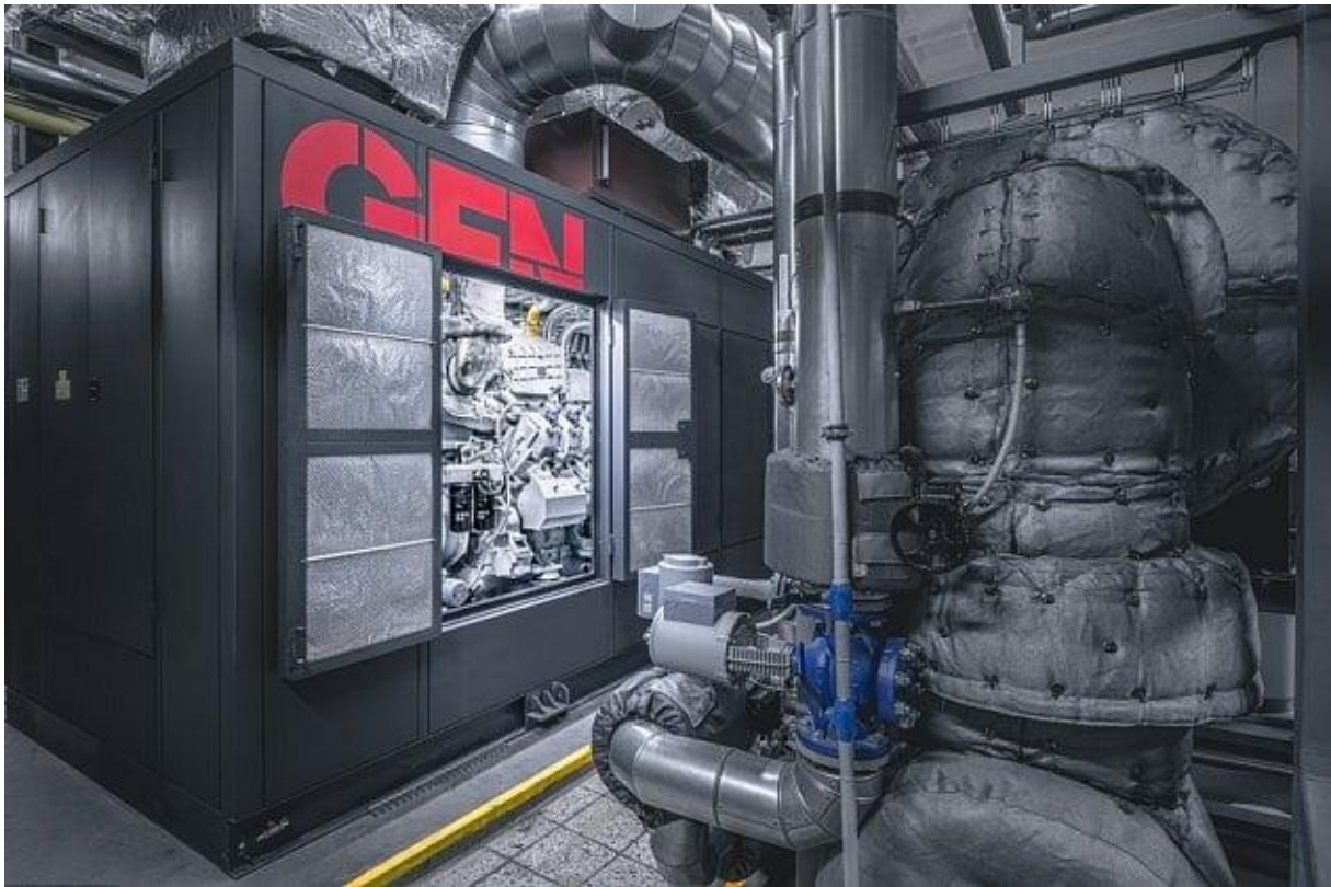
Na obrázcích jsou příklady různých instalovaných KGJ.
